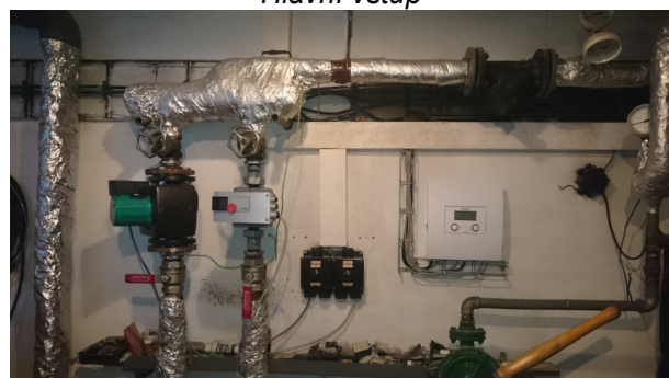
Hlavní rozvod ÚT, ekvitermní regulátor
